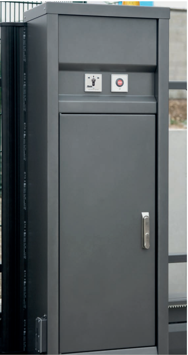
Antriebs- und Steuersäule
