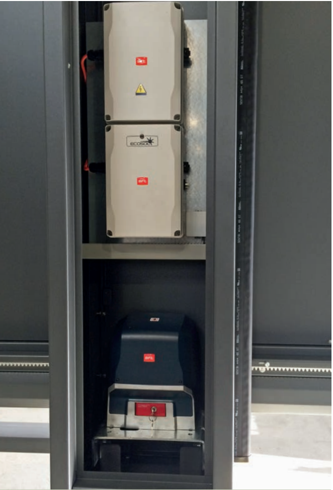
Innenraum der Antriebs- und Steuersäule
